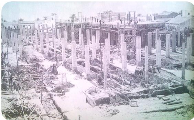
Obres de reconstrucció a la fàbrica Pirelli, l'any 1941. Imatge: Arxiu Cables Pirelli
